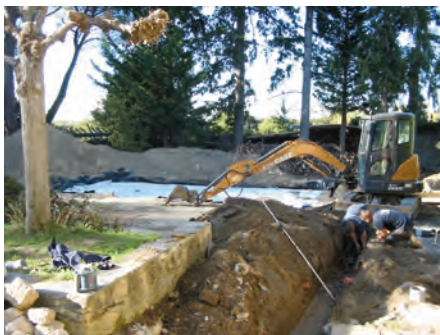
Station d'assainissement au prieuré
